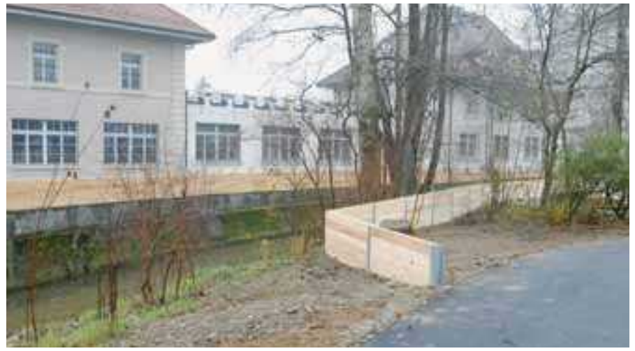
Massive Eisenprofile mit Holzbrettern sollen die Wassermassen aufhalten
